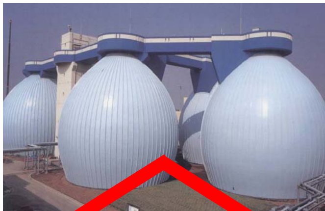
下水汚泥から下水道バイオガスを回収する消化槽
